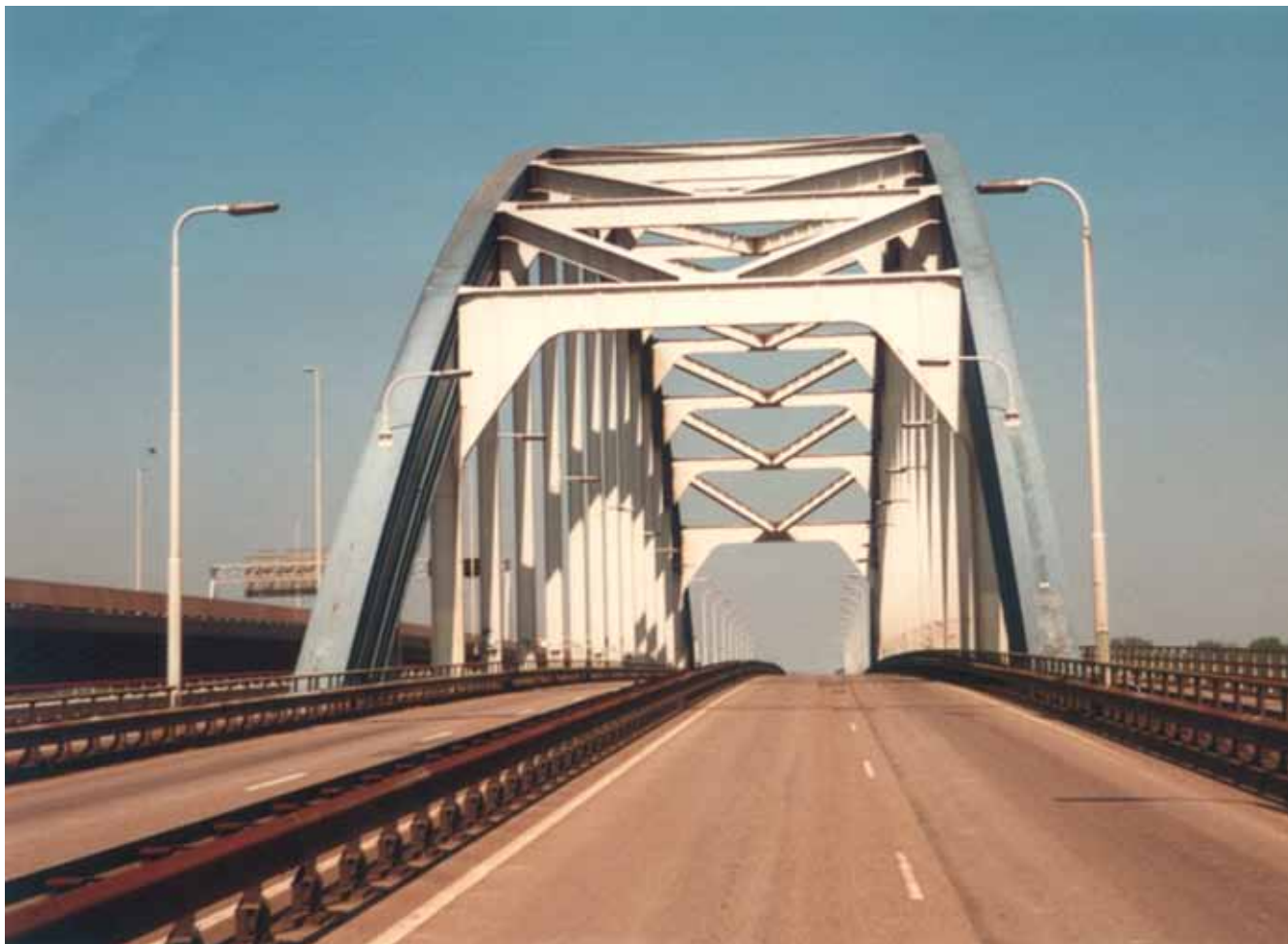
Figuur 23b toepassing van eindportaal in het vlak van de verticale hanger.
