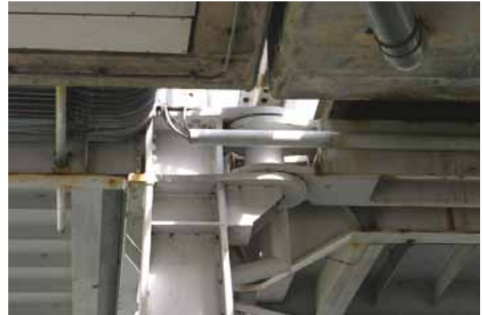
Detail onderzijde bovendeck bij de aansluiting op het betonnen viaduct (foto Ciska Klooster)
