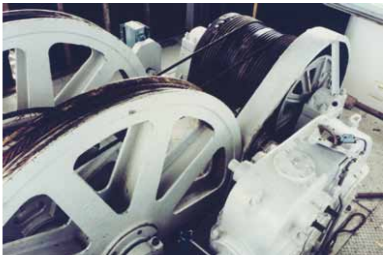
De aandrijving van het bewegingswerk (foto Bouwdienst Rijkswaterstaat)
