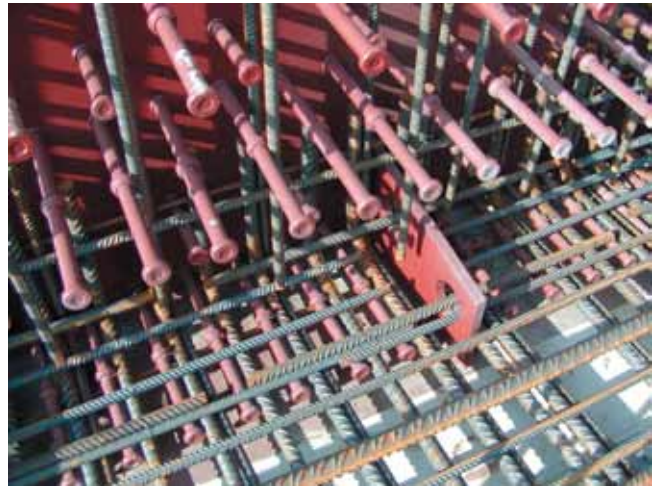
7. Deuvels aan de binnenzijde van de stalen hoofdliggers zorgen voor goede aansluiting aan de betonvloer.
