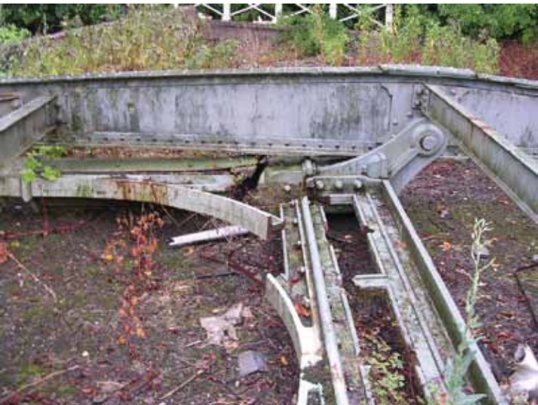
Detail van de kapot gereden onderdelen van de bovenbouw. (foto: HHSK)
