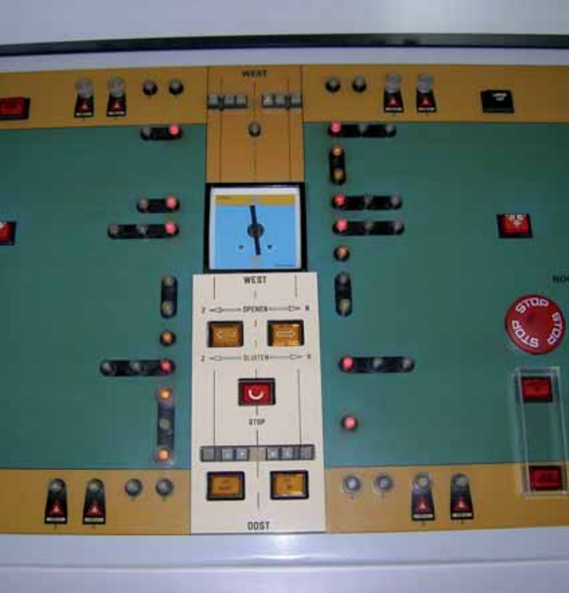
Afb.2. Compacte bedieningsterminal draaibrug Sluiskil
