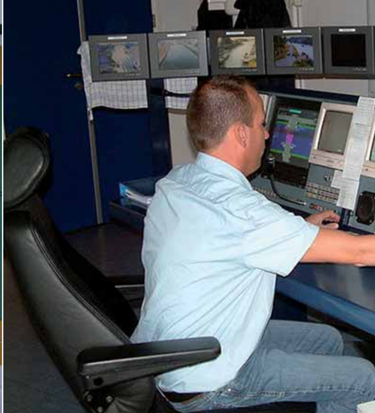
Afb.3. Centrale Bediening Gorinchem, bruggen Merwedekanaal (foto PZH)
