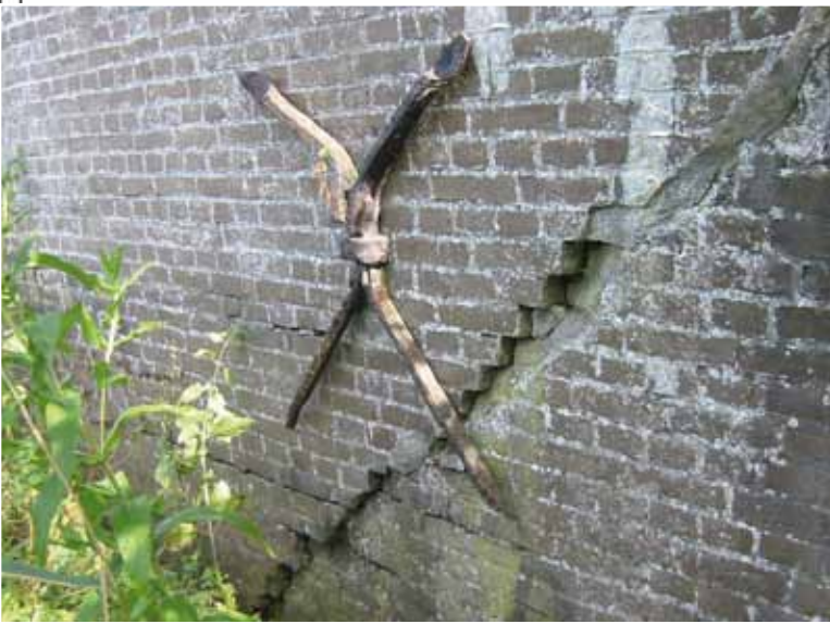
afb.9. Tekening van de toestand voor herstel van de Steentil afb.10. scheur in het metselwerk
