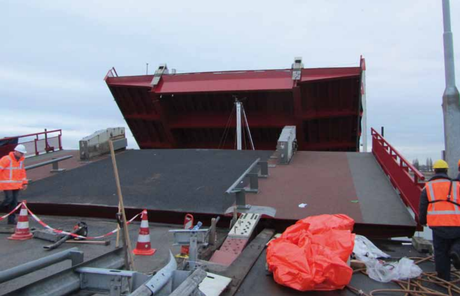
Linkerpagina: Schellingswouderbrug rechterpagina: Maart 2012 Plaatsen nieuwe dubbele basculebruggen met een boutverbinding voor draaipunt Schellingswouderbrug basculebruggen
