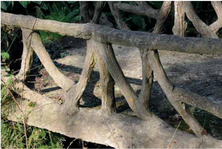
Brug in cementrustiek in het park van paleis Soestdijk. De waardering en zeldzaamheid van de bruggen is vanwege de combinatie van kunstmatig materiaal en semi-natuurlijke vormgeving bijzonder. Technisch zijn dit soort bruggen wel uitdagingen. Foto's Gert Jan Luijendijk, 2009.
