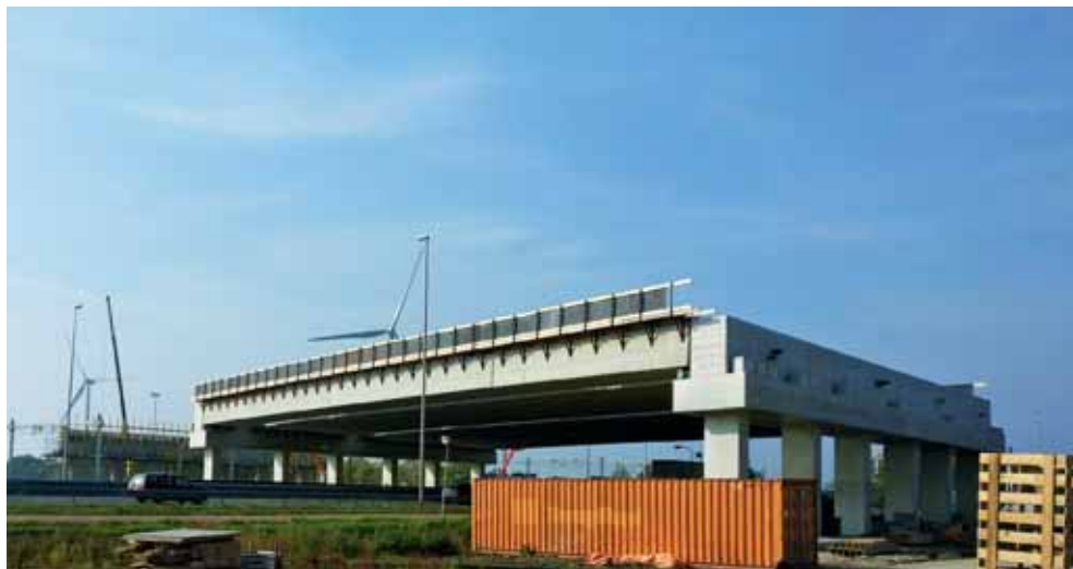
De liggers boven de A12 zijn geplaatst in een weekend waarbij de snelweg buiten dienst was gesteld.
