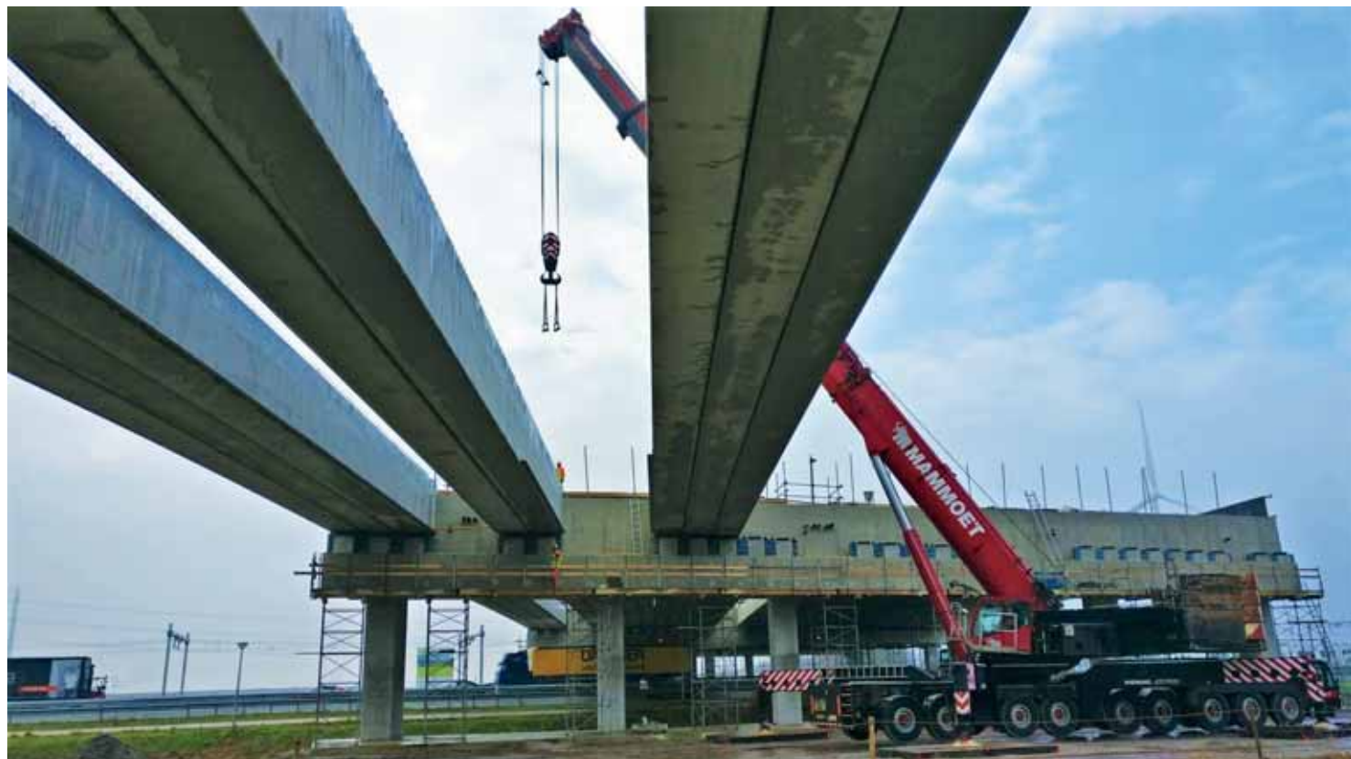
Tussensteunpunt is asymmetrisch belast in bouwfase.
