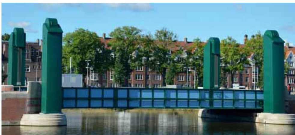
30 Het voormalige stalen val als vast brugdek in de Gevlebrug © Gebr. Beentjes GWW, 2020
