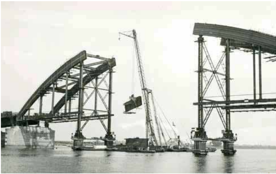
11 Het herstel na de oorlog verliep op een andere manier dan de bouw vóór de oorlog. bron: archief Nederlandse Bruggenstichting
