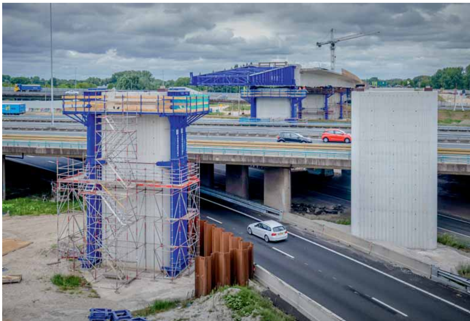
2 hulppijlers naast pijlerwanden.
